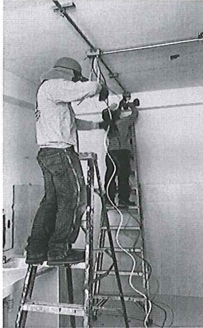
CABLEADO ELECTRICO EN SSHH
